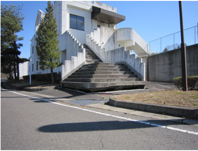
管理棟入口（陥没）
