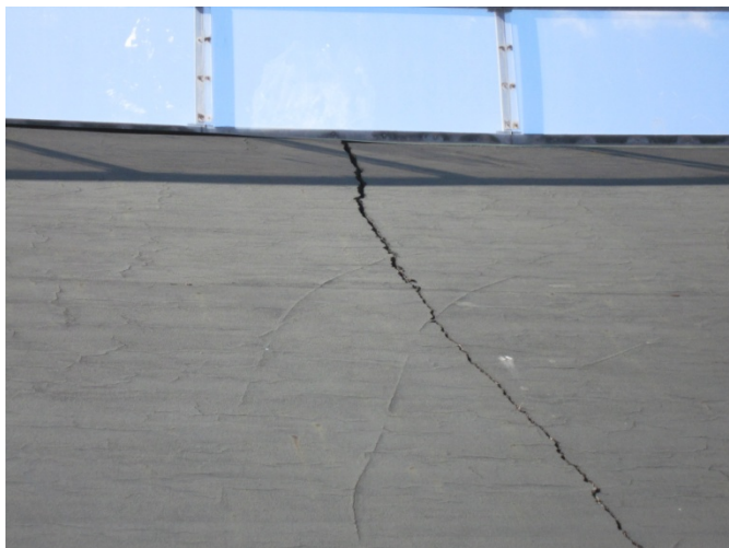
1センター付近（亀裂）
