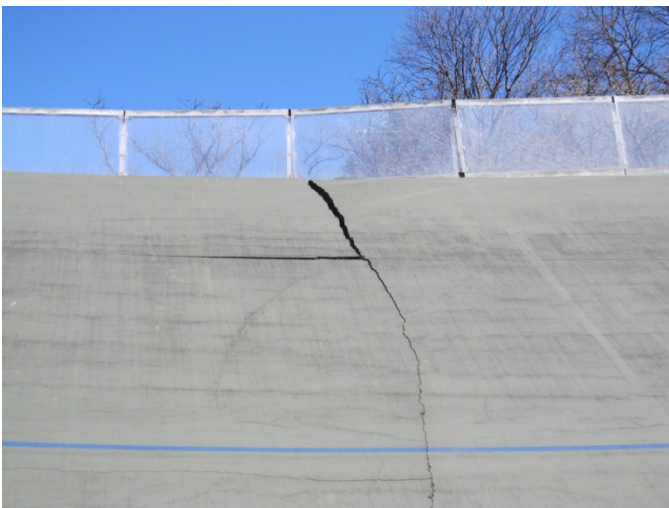
4 コーナー付近 (亀裂)
