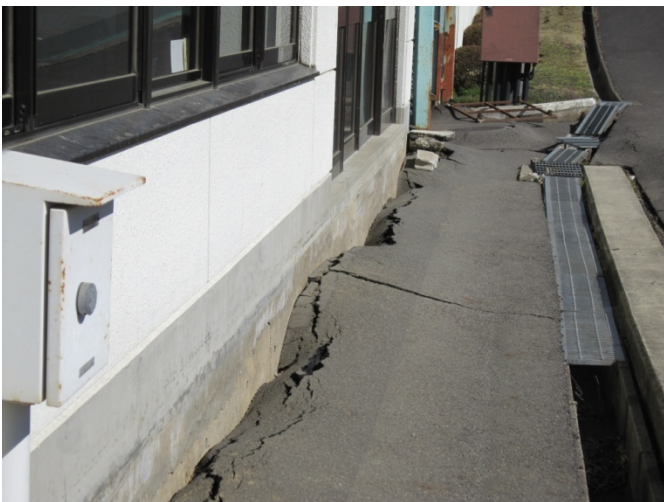
管理棟入口（陥没）
