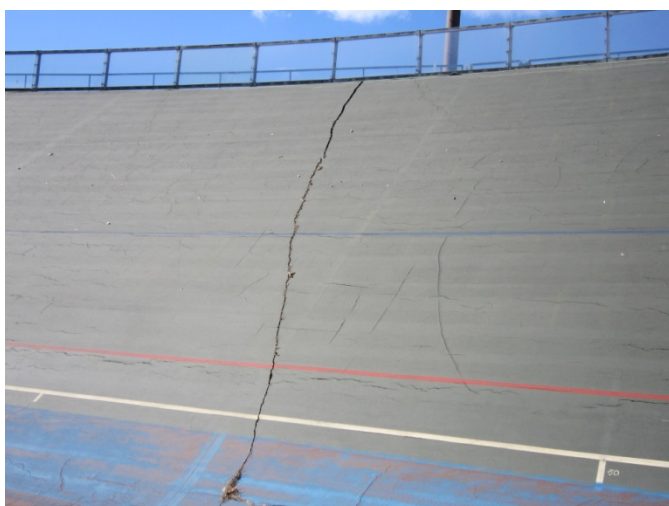
1センター付近（亀裂）
