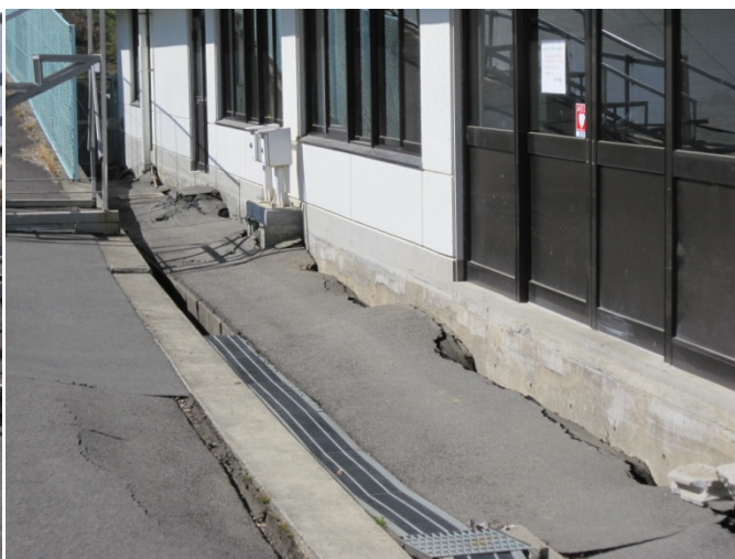
管理棟周辺（陥没）
