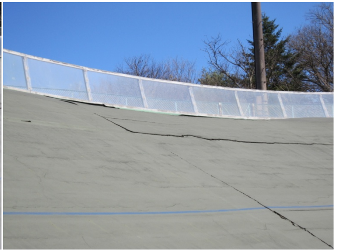
4 コーナー付近 (陥没・亀裂)
