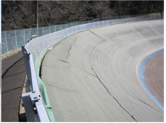
4 コーナー付近 (陥没・亀裂)
