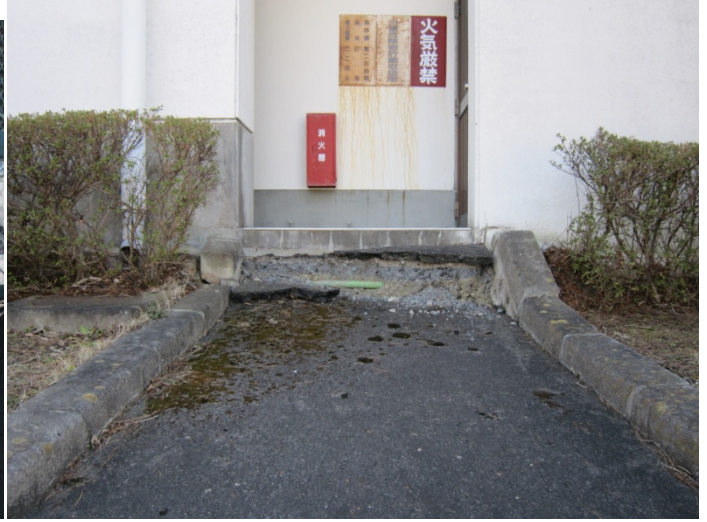
管理棟裏（陥没）
