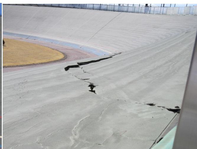
第1コーナー付近（亀裂・陥没）
