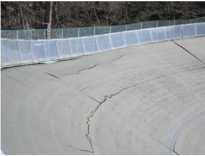
4 コーナー付近 (陥没・亀裂)
