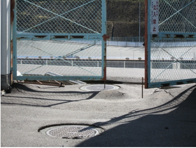
自転車競技場入口付近（陥没）
