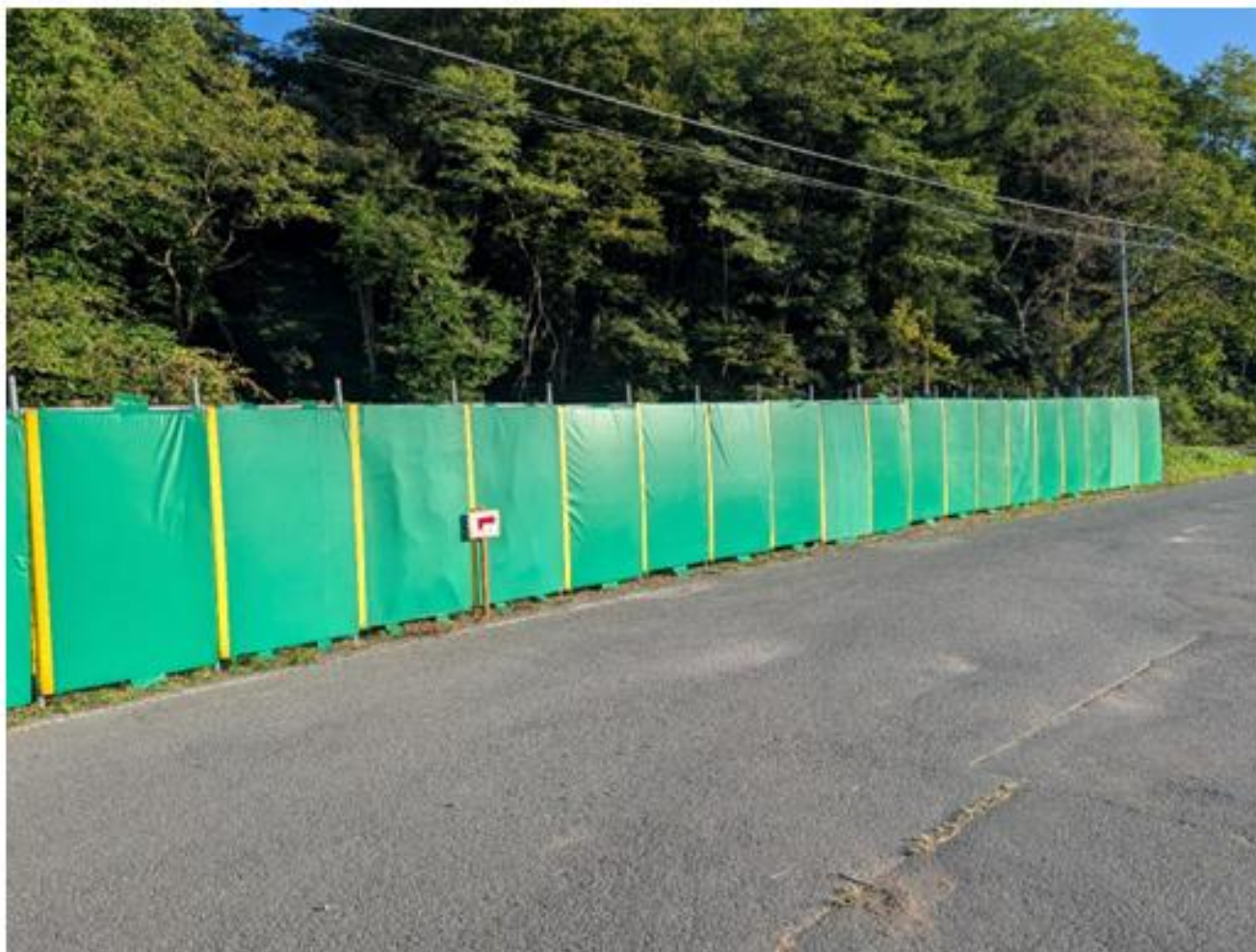
安全対策①（セーフティフェンス）
