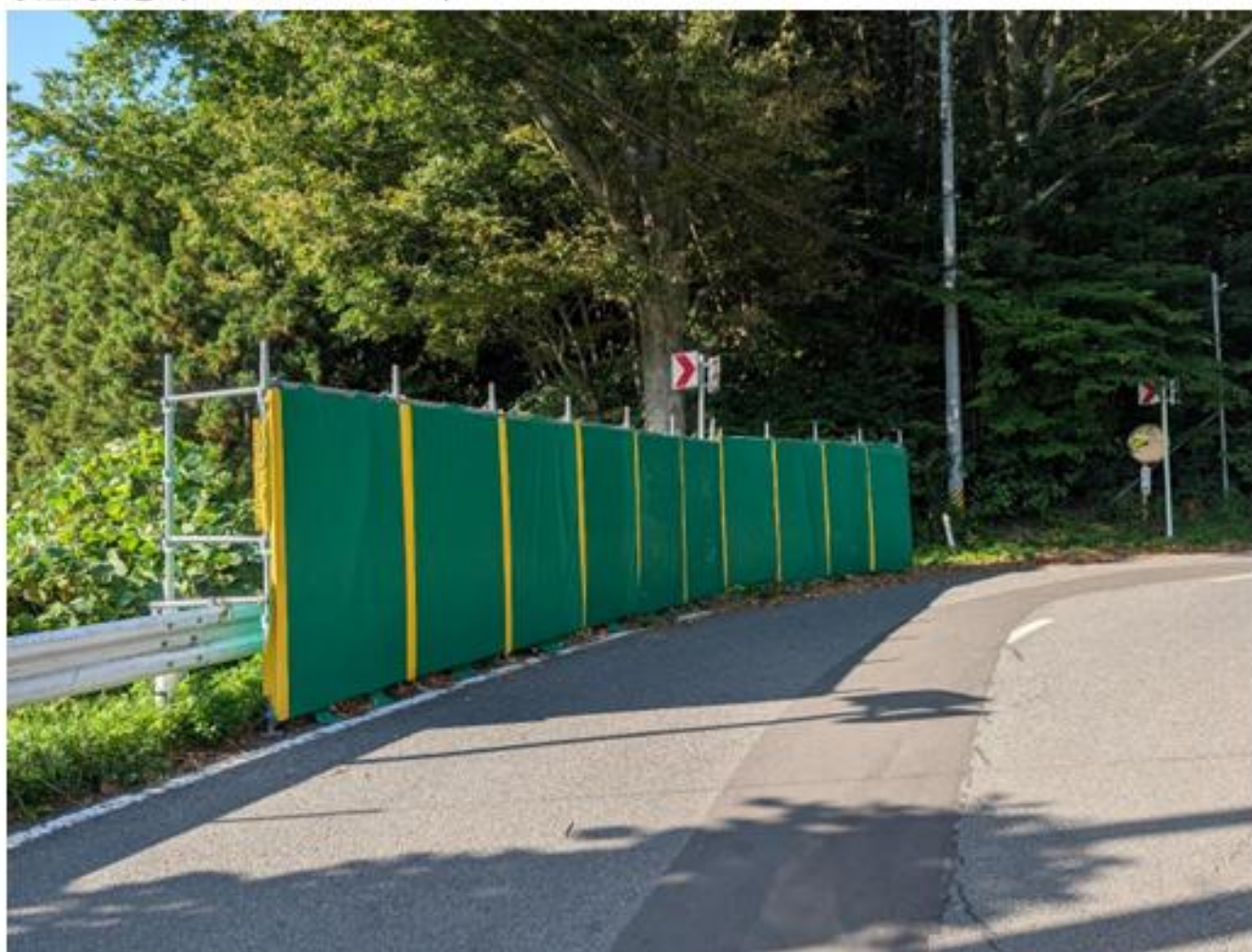
安全対策①（セーフティフェンス）
